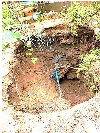
中宿町会員宅の庭陥没 (高尾町)
